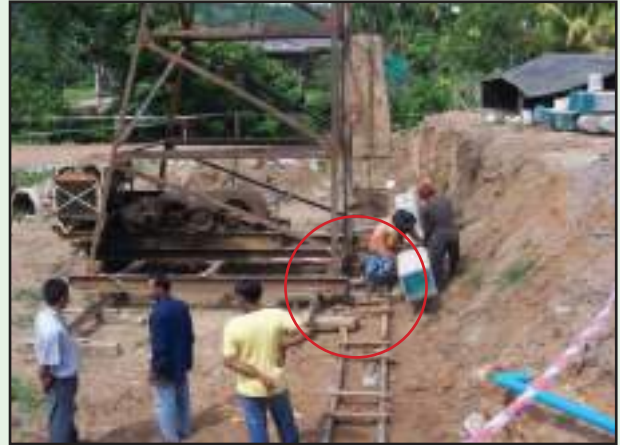
การวางปั้นจั่นบนดินอ่อนอาจล้มได้
