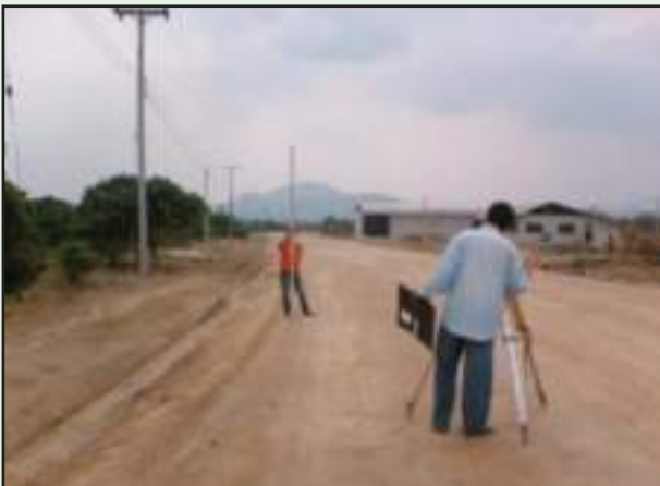
รูปที่ 4-18 ทำการตรวจสอบระดับหลังจากทำการเกรดบดอัดโดยละเอียด (Fine Grade)
