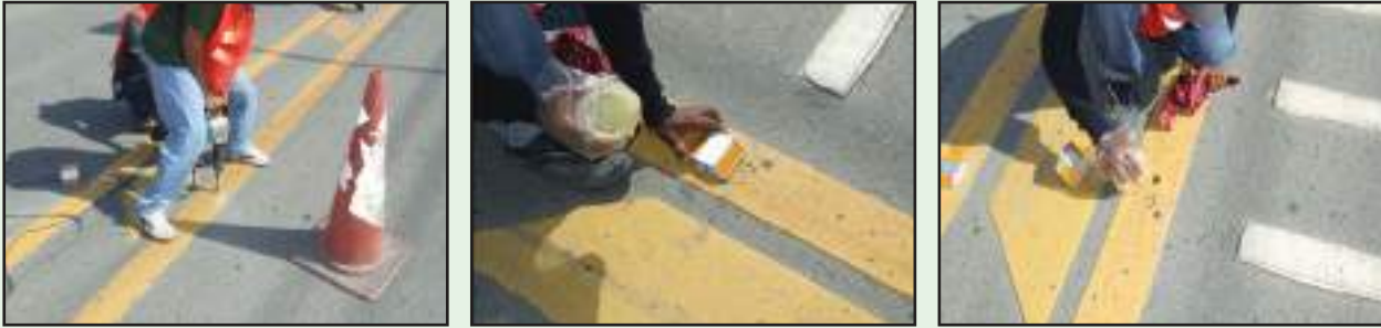
รูปที่ 7-6 รูปแสดงการติดตั้งหมุดสะท้อนแสง
