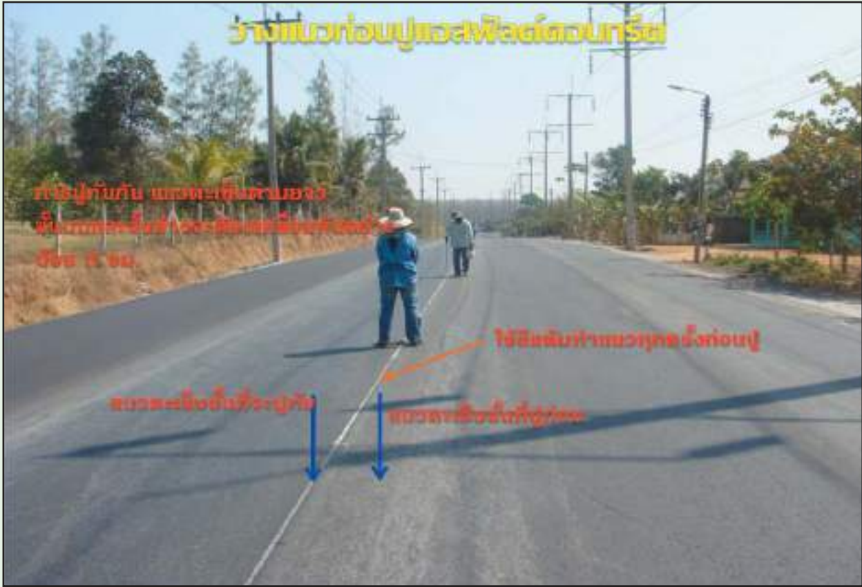
รูปที่ 6-29 แสดงการวางแผนแนวเกลี่ยปูแอสฟัลต์คอนกรีตชั้นถัดไป
