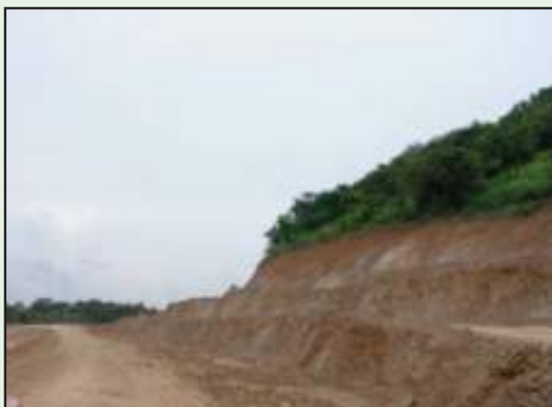
รูปที่ 4-27 การขุดตัด Back Slope ที่สูงมากๆ ให้ตัดแบบมีชันพัก
