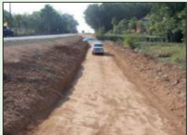
รูปที่ 4-16 หลังจากการบดอัดแต่ละชั้น ทำการทดสอบความแน่น
